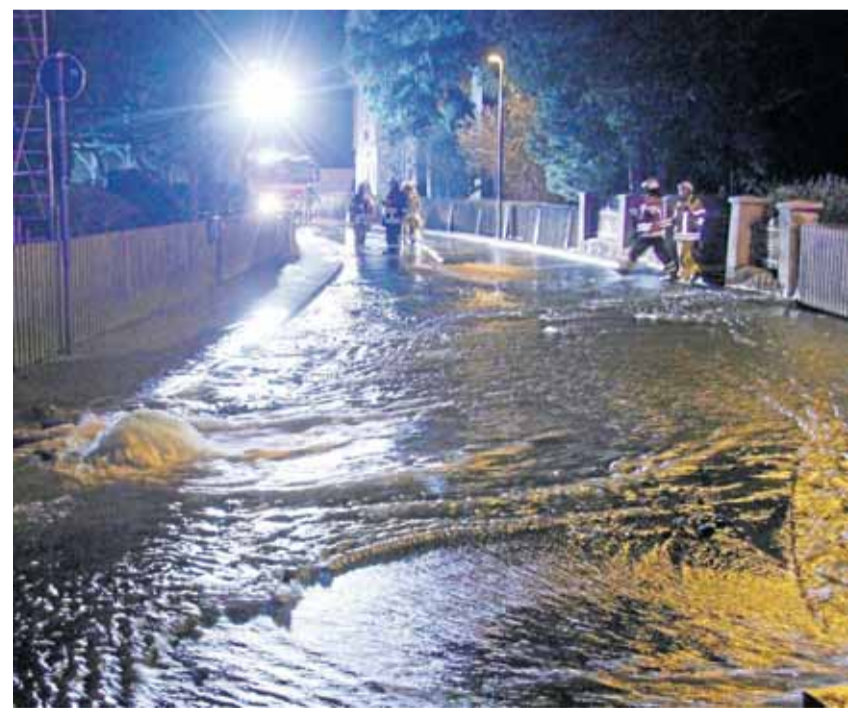
Ein etwa einen Meter langer Riss in einer Transportleitung setzte am Freitagabend die Burgstraße unter Wasser. Fotos: Schlegel
