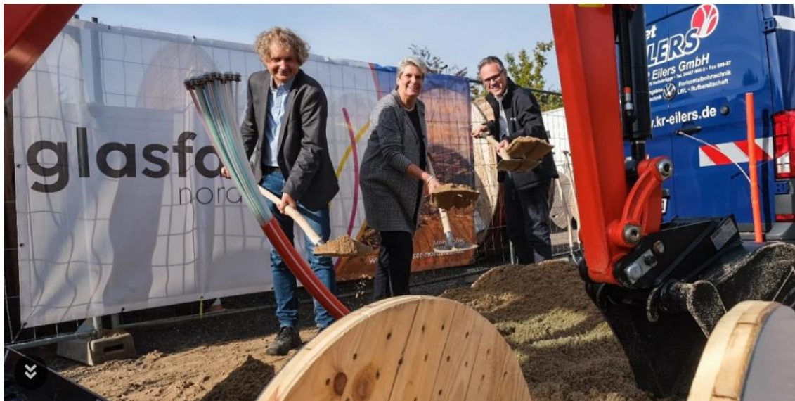
Beim ersten Spatenstich für das Glasfaserkabel in Ennigloh: (von links) Manfred Rebnau (Geschäftsführer Circet K & R Eilers GmbH), Bürgermeisterin Susanne Rutenkröger und Andreas Mayer (Geschäftsführer Glasfaser Nordwest) Bild: Kathrin Weege
